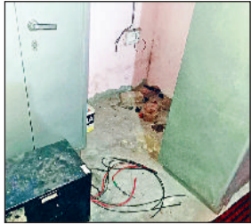
झज्जर। प्राचार्य कक्ष में यहां रखी थी बैट्रियां व इवर्टर। फोटो: हरिभूमि
